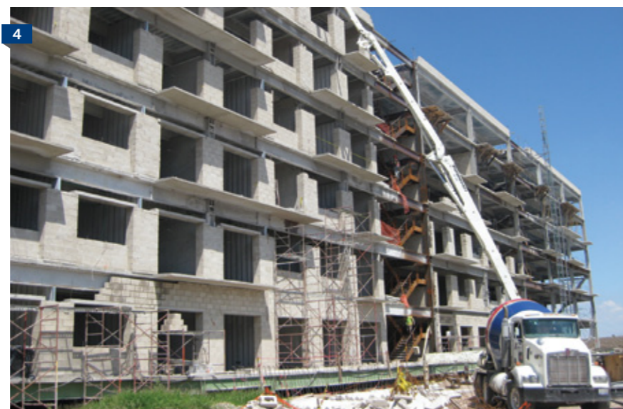
1. La Ribera 2 y 3. Concreto Profesional MR Ligero Estructural 4. Villa Panamericana, Guadalajara, Jalisco
